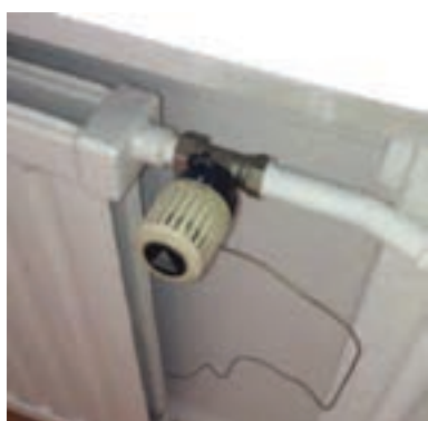
Gl. radiator og termostat
