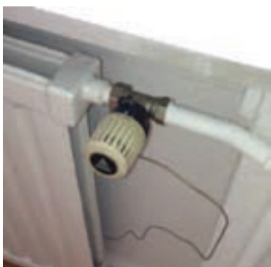
Gl. radiator og termostat
